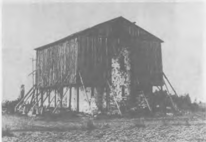
Рис. 13. Шатер над руинами церкви Спаса на Нередице после проведения консервационных работ. Вид с юго-востока. 1955 г.
