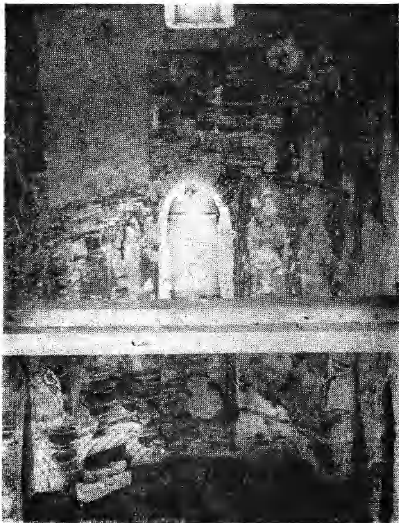
Рис. 16. Центральная апсида Нередицкой церкви после восстановительно-реставрационных работ 1956 года. В верхней части новая кладка обмазана сплошной обмазкой.
